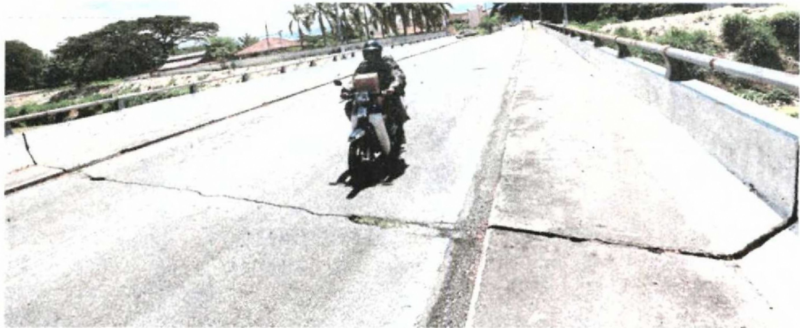
Tinjauan di Jambatan Sungai Pari di Jalan Gudwara Buntong, Ipoh yang retak dan membahayakan pengguna jalan raya.
