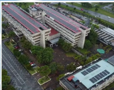
Canselori Putra dan PPPA (354.20 kWp)
